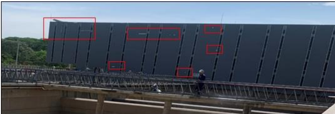
Imagen no. 1 desprendimiento fachada
