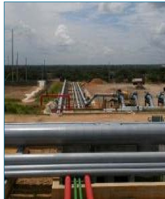
Bicentenario: rack de tubería
