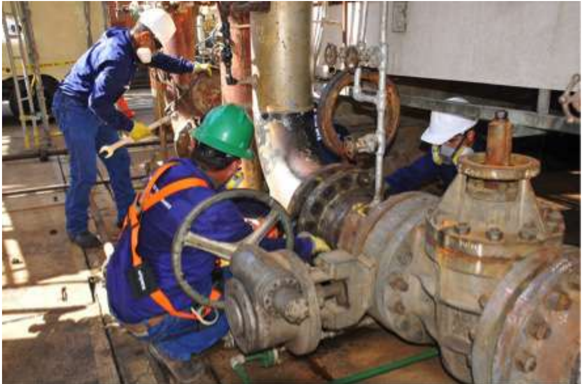
Trabajadores en la Unidad de Aromáticos, de la Refinería de Barrancabermeja.
